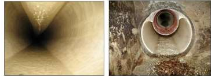
Schmutzwasserkanal als Vakuumleitung im bestehenden Kanal, der weiterhin zur Ableitung des Oberflächenwassers dient
